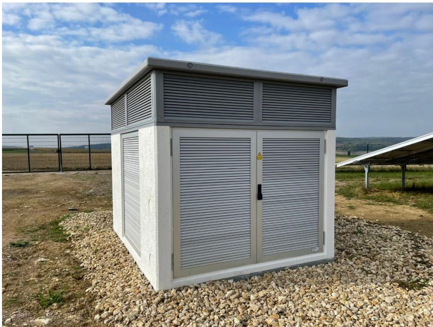
Abb. 6: Beispiel einer Trafo-Station (Quelle: Fa. Sandmeyer, Cadenberge)
